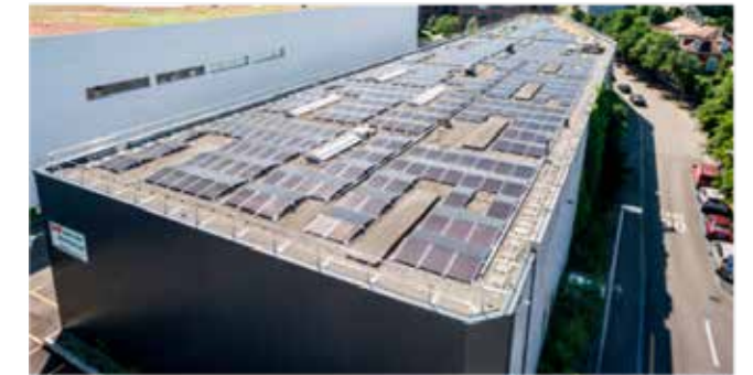
Installation PV de Marksteiner (env. 1000 m 2 )
