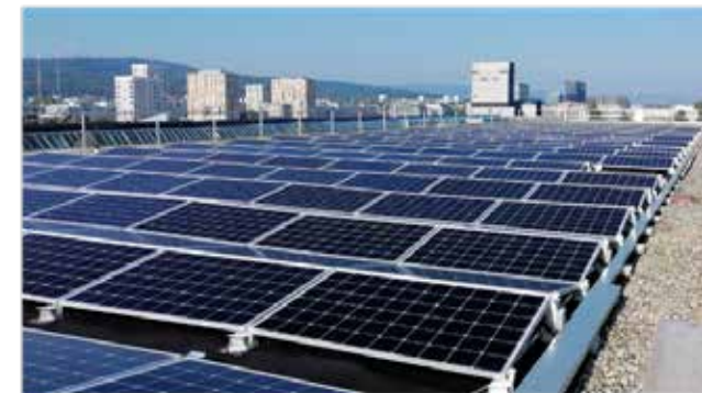
Installation PV de Kellenberger (env. 2500 m 2 )
